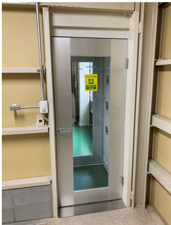
入口にエアシャワーを完備
